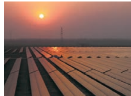
■ 亞洲最大、技術含量最高的薄膜太陽能光伏電站——華瀚光伏電站
