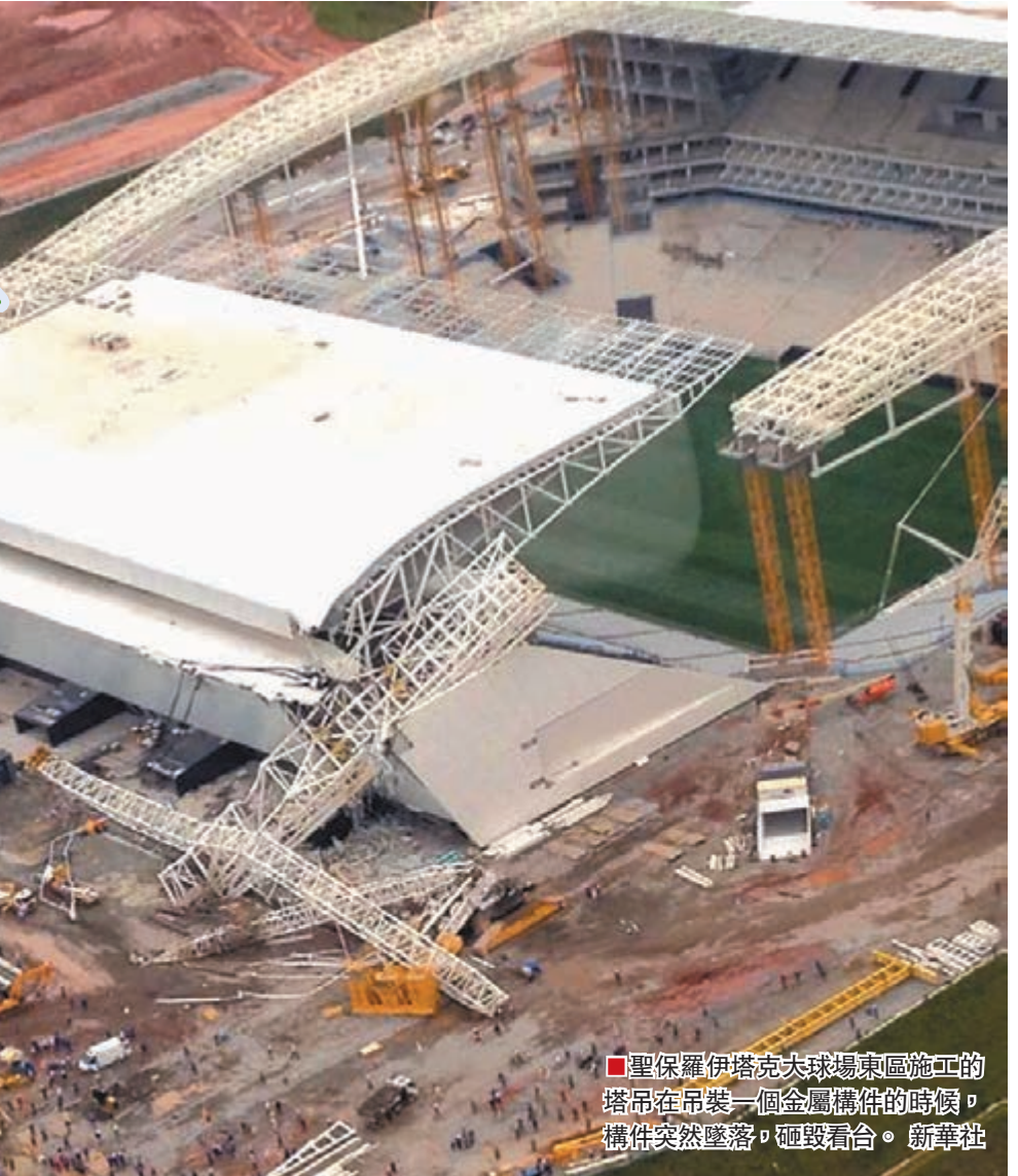
聖保羅伊塔克大球場東區施工的塔吊在吊裝一個金屬構件的時候，構件突然墜落，砸毀看台。新華社
