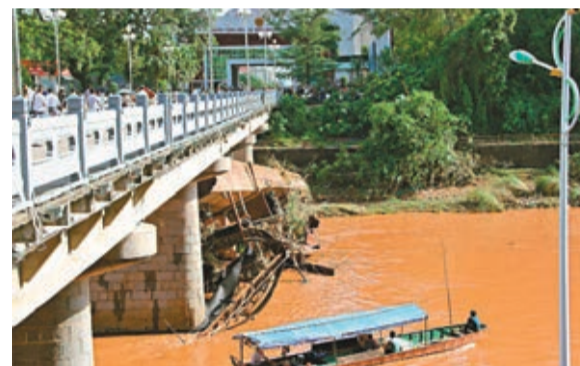
廣西東興一艘採沙船卡在北侖河中越友誼大橋橋底。
