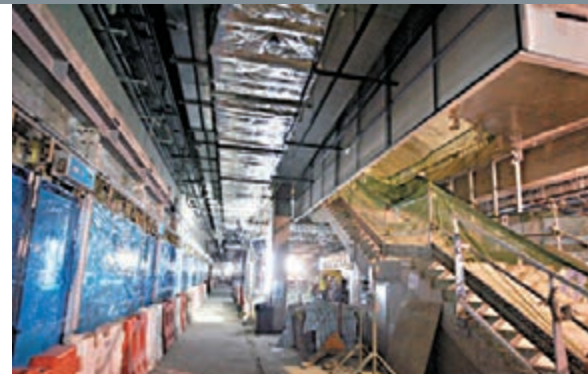
港鐵西港島線各站月台幕門大致安裝完成。香港文匯報記者莫雲芝攝
