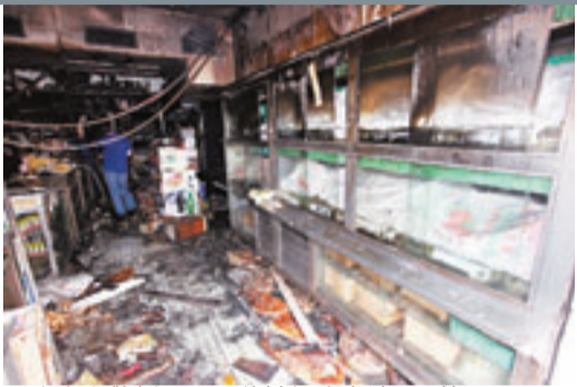
▲發生火警新三陽,估計損失高達200萬元。
