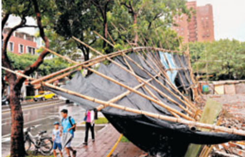
■颶風菲特暴風圈進入台灣東部及北部陸地。圖為台北市一處工地圍籬被風吹倒。 中央社
