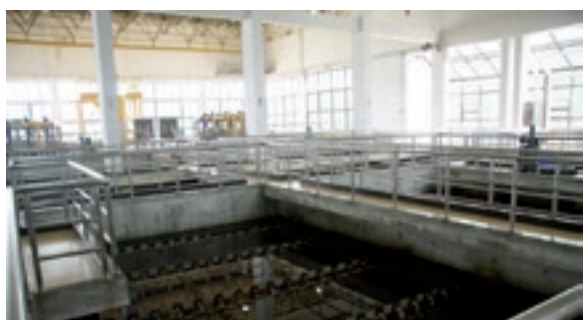
■北京市自來水集團公司第九水廠沉澱池
