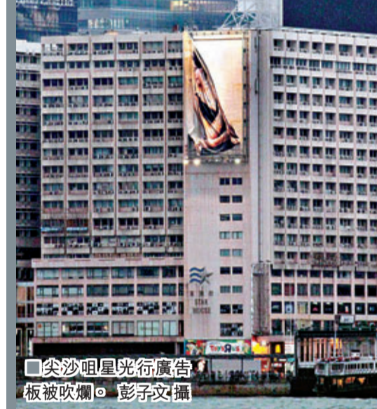
尖沙咀星架行廣告板被吹爛。 彭子文攝
