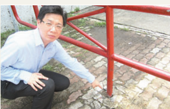
■民建聯社區主任林健根指出消防閘的地面固定設施已見損耗。 民建聯供圖
