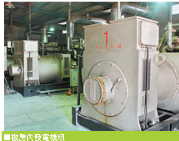
機房內發電機組
