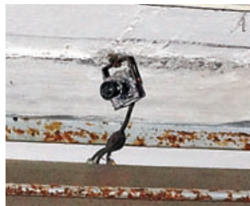
翠屏邨非常父親屋外安裝有閉路電視。
