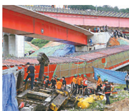
翻側的重型機器與瓦礫一同跌下橋底。網上圖片
