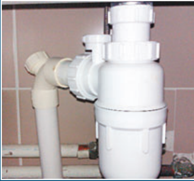
■洗手盆底去水喉接口未扭緊。鍾智剛提供
