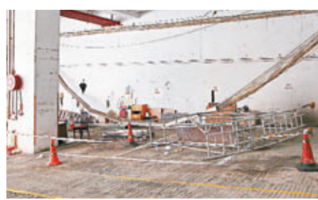
下塌的電線槽將工作台撞翻。劉友光攝料電線槽整個鬆脫,由中間位置呈「U」字型下墜擊中工作台,工作台傾失平衡翻倒,2名工人同告墮地受傷,大廈管理員見狀報警。
