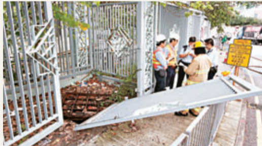
鴨洲洲發生地底爆炸彈出渠蓋撞塌大閘的建築地盤。
