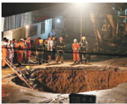
■塌陷現場形成一個直徑約10米、深度約2米的大坑。本報深圳傳真
