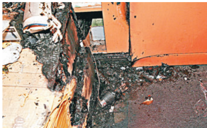
■手機舖疑因熱風槍過熱波及壓縮氣體罐引起爆炸一角。
