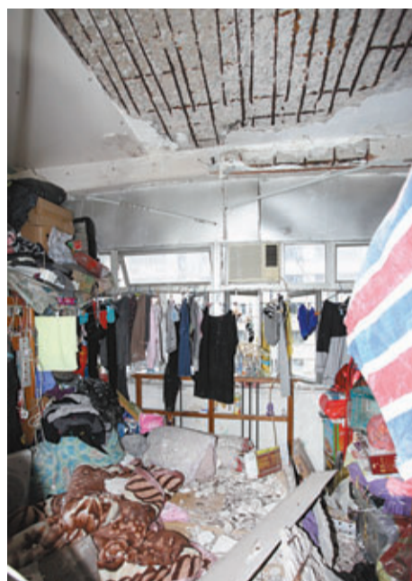
東京街發生大面積天花剝落的單位。
