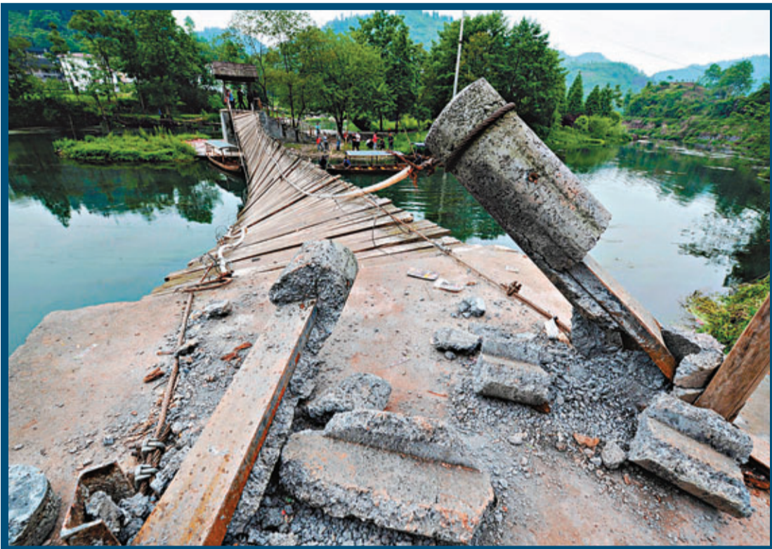
■湖南鳳凰縣桃花島跨河吊橋橋墩已嚴重斷裂。中新社
