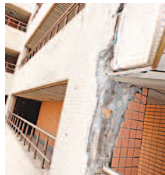
受到南投地震影響，台中市一棟大樓的外牆水泥塊剝落，伸縮縫裂開，水管爆裂導致電梯積水，上百名住戶出入得爬樓梯。圖為大樓外牆水泥塊剝落。
