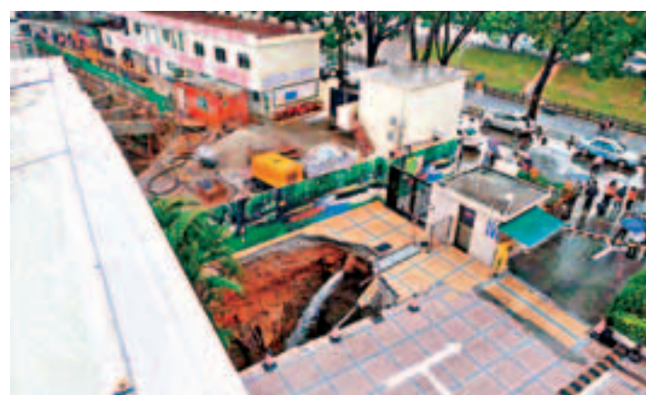
■地陷處不足4米處正在建設「文博大廈」。香港文匯報深圳傳真
