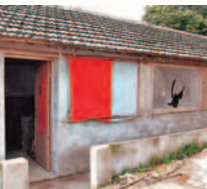
■農戶豬舍設施簡陋，僅以塑料薄膜當牆。
