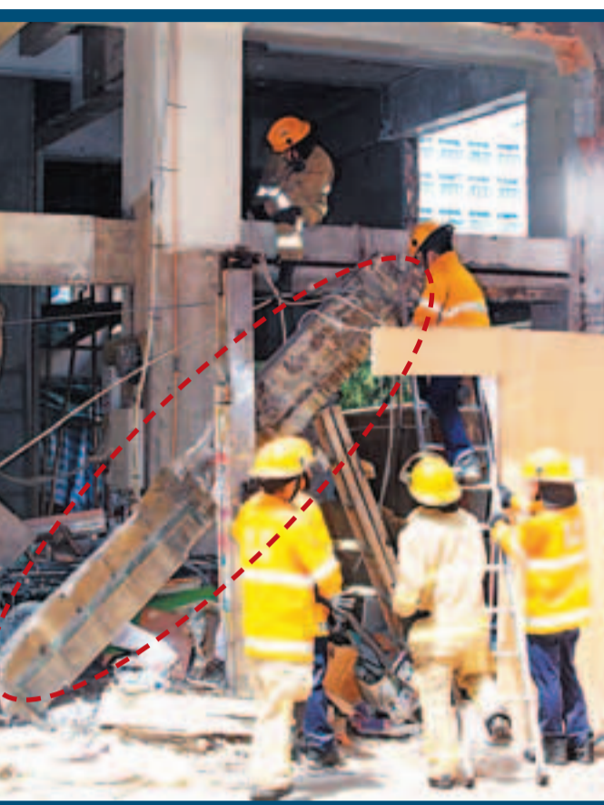
廟街地舖發生倒塌的鋼筋混凝土(紅圈)證實不涉樓宇結構。
