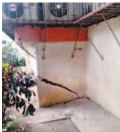
深圳羅湖鹿丹村13棟樓房後牆因使用了海砂，出現寬達5至7公分的大裂縫，成為危房。本報記者 李昌鴻攝
