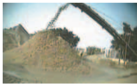
■深央視報道指出，深圳有大量的建築違規使用海砂。圖為深圳某處理海砂的工地。
