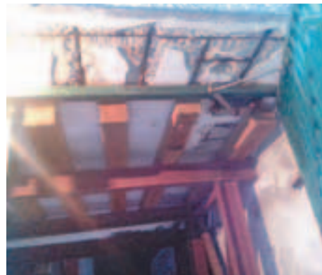
■羅湖鹿丹村一棟樓房因使用了海砂，其房屋鋼筋遭腐蝕，只得用鐵架支撐。
