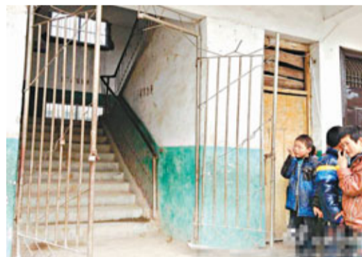
左側鐵門被擠破,上下分離。
