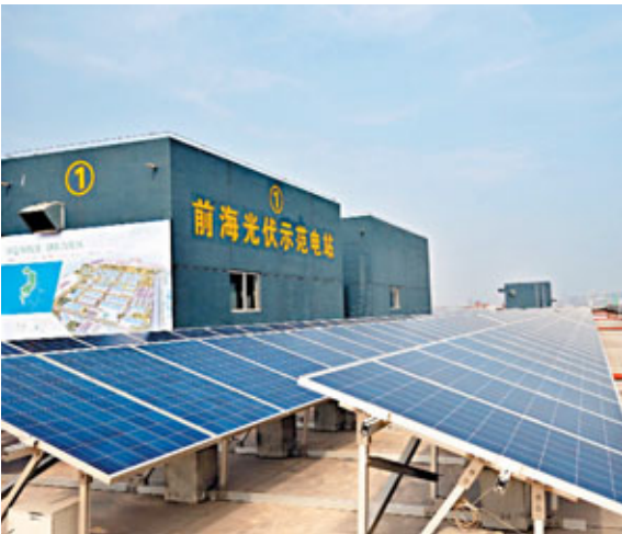
■前海光伏示範電站目前總裝機總量2.5MWp，已經能為保稅港區提供60%的電能。
