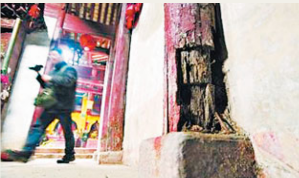
■閣內的木柱被江水浸泡腐蝕。 網上圖片
