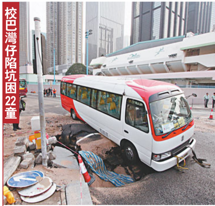
一輛載22名學童校巴,昨午4時許沿老誌道右轉入鴻興道時,因地下水管爆裂沙泥隨水沖走,路面失承托下陷,校巴右前胎跌進坑中,車上學童被困尖聲呼救,消防接報大為緊張,調派流動傷者治理車及多輛救護車到場戒備,消防員用工具固定車身後將學童陸續救出,幸各人均無受傷毋須送院。
