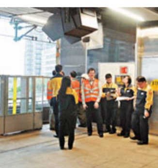
路軌出現裂縫後，有工程人員經牛頭角站入內進行臨時鞏固工程。
