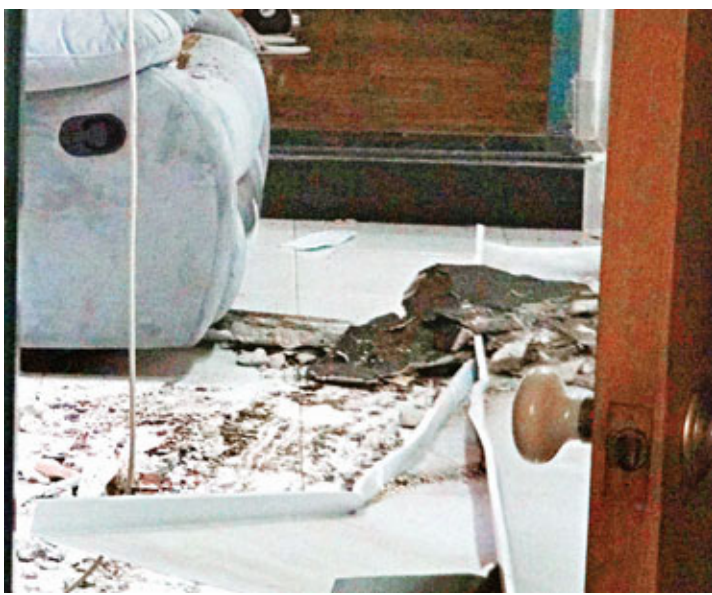
女傭墮樓插進平台屋，跌落在沙發旁邊，地面遺下大量屋頂天花碎石。
