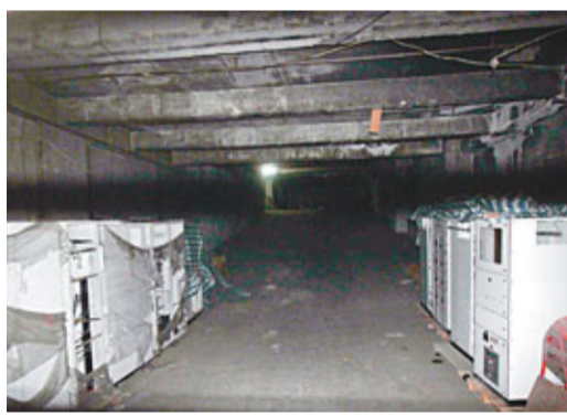
現場一批掣櫃被拆去銅片。
