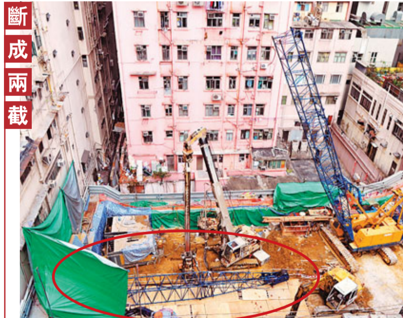
皇后大道西近山道一個地盤發生罕見意外，昨午2時許，地盤內一部履帶吊臂機起吊貨物時，吊臂突斷成兩截，斷開的10米前截(紅圈示)撞向隔鄰大廈，導致外牆一條水管爆裂噴水，大廈低層住客須一度疏散，幸事件未釀成傷亡，警方及勞工處正調查肇因。
