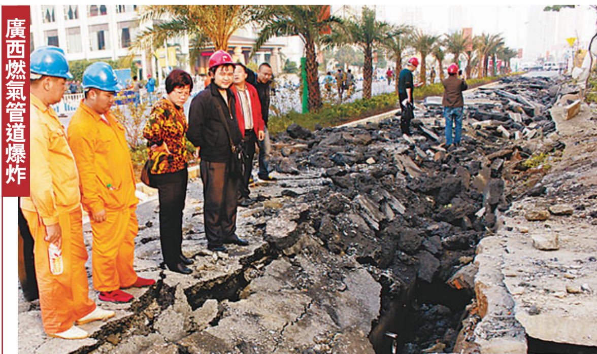
廣西北海市一住宅小區旁地下管道昨日發生爆炸，導致約80米路面被炸開，目前尚無人員傷亡。據現場初步調查，發生爆炸的地下埋有燃氣管道、電纜等。從廣西北海市有關部門獲悉，據初步判斷，有可能是地下燃氣管道洩漏，遇到高壓電纜火花引發爆炸，最終結論需抽樣檢測後才能得出。目前，事發小區的燃氣供應已被暫時關閉。 中新社
