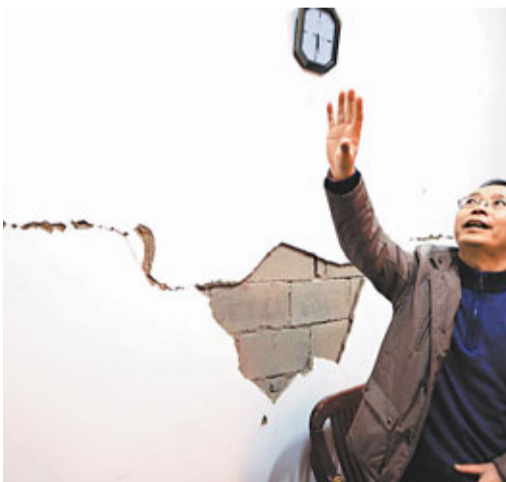
震中燈塔市柳條鎮政府辦公樓內一房間震後發生牆皮脫落現象。 中新社
