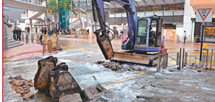
灣仔萬茂里一個掘路工程地盤,昨午1時50分,有工人疑意外擊穿地底一條18吋粗食水管,水柱直衝半空,高逾2層樓,一輛七人車經過被水柱激出沙石擊毀車尾玻璃,尾隨其後的士則被激出碎石擊中車底及車頭頂,的士事後更為「死火」。劉友光攝
