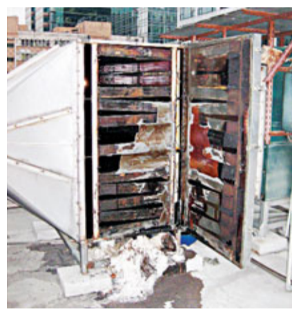
東建工廠大廈中藥廠在天台發生火警的烘藥焗爐。
