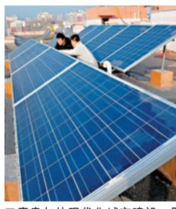
青島加快現代化城市建設。圖為內地首個居民用戶分佈式光伏電源在青島市供網發電。 新華社
