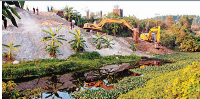
■工作人員在修築土壩阻止洩漏原油進入赤坎水庫。
