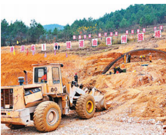
■圖爲新開工建設的貴州東北繞城高速公路尖坡至小碧段漁洞峽一號隧道出口。李黔剛攝
