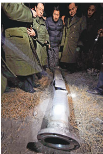
■導致山西天脊煤化工集團苯胺洩漏事故發生的破損管道。 新華社
