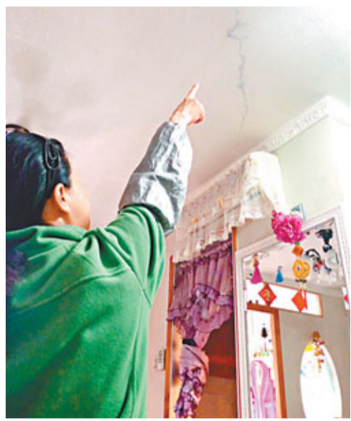
被腐屍水滲入屋內的單位女戶主魯女士指示天花上的滲漏位置。
