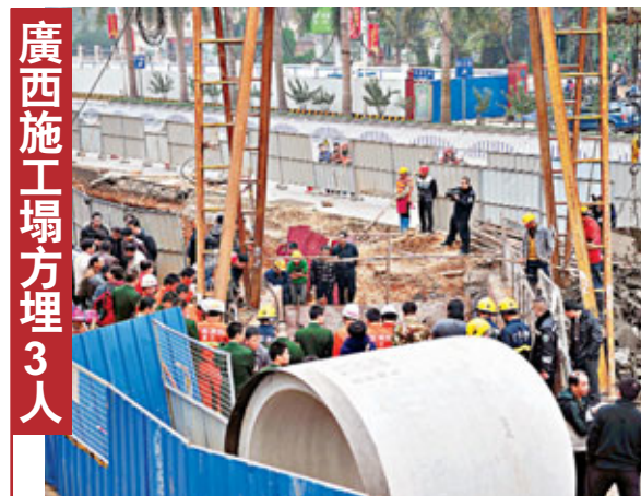
廣西南寧市民族大道市政污水管線施工現場2日下午發生塌方事故，3名工人被埋。截至當晚7時，仍有1人被埋。
