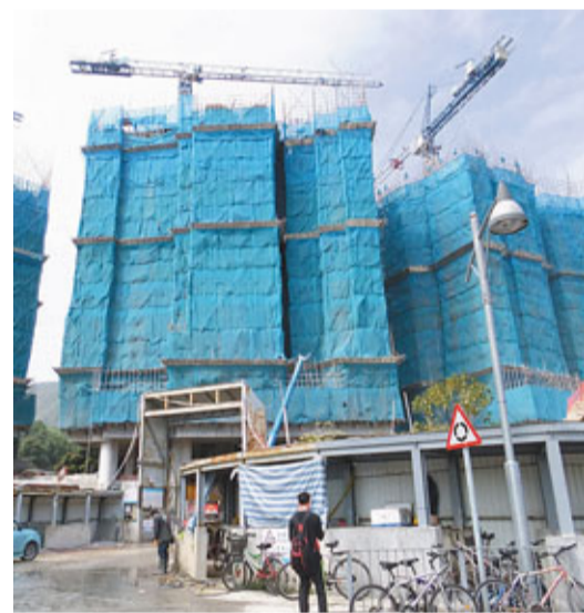
大埔鳳園路工人墮樓被鋼筋貫體的地盤。劉友光攝
