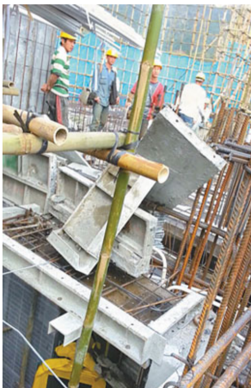
慘遭鋼筋貫體工人失足墮樓之處有多條鋼筋。記者劉友光攝
