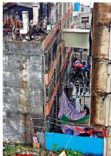
工廠右下角為逃生門，被改造成鐵欄杆圍死。
