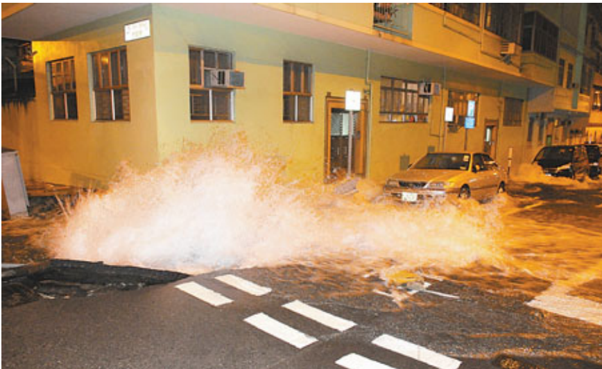
■西灣河太富街地底水管爆裂，大量食水湧出路面。
