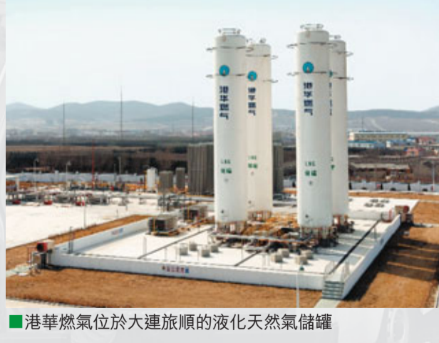
港華燃氣位於大連旅順的液化天然氣儲罐
