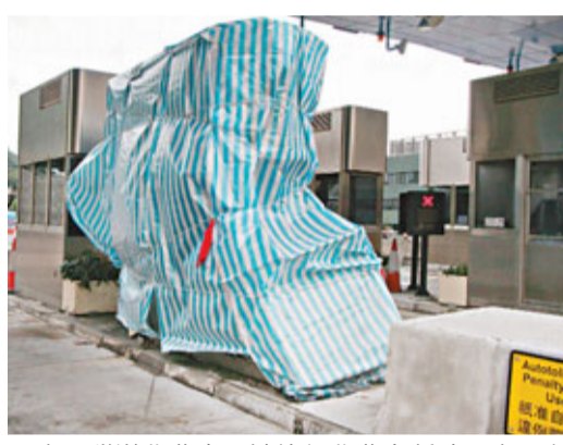
尖山隧道收費廣場被撞毀收費亭暫時以大膠布覆蓋，等候維修。
