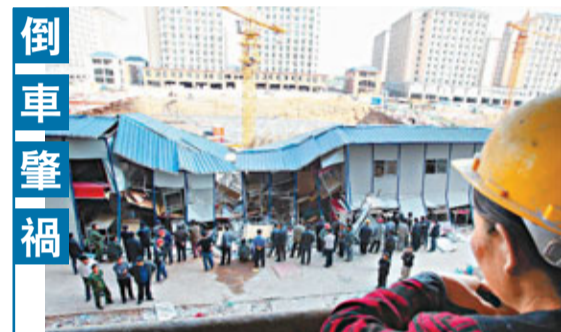
在鄭州航空港區保稅路一商住項目建築工地內,24日凌晨一輛施工車輛在倒車時意外側翻,砸塌路邊工棚,造成8人死亡、6人受傷。中新社
