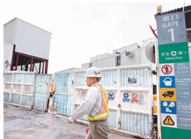
發生工業意外的港鐵西港島線地盤。
