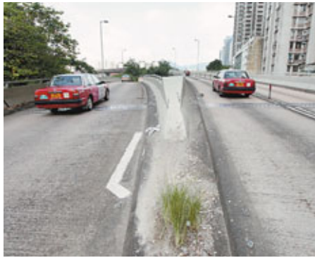
■現場牛頭角道天橋2條北行線分岔路口的石屎斜台，有撞擊痕跡及胎痕。
